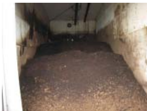
悪臭吸着槽 (床面から悪臭を導入)
